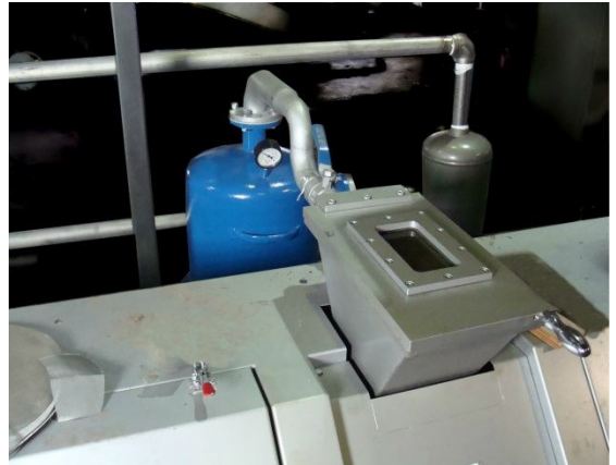
真空排気システムの稼働の様子
