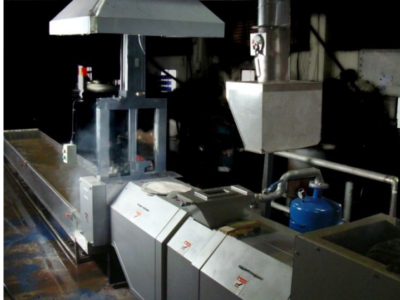
真空排気システムの稼働の様子
