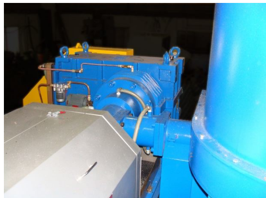
貯蔵タンクから親機押出機結合部
